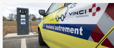
^ Bornes de recharge pour véhicules électriques
